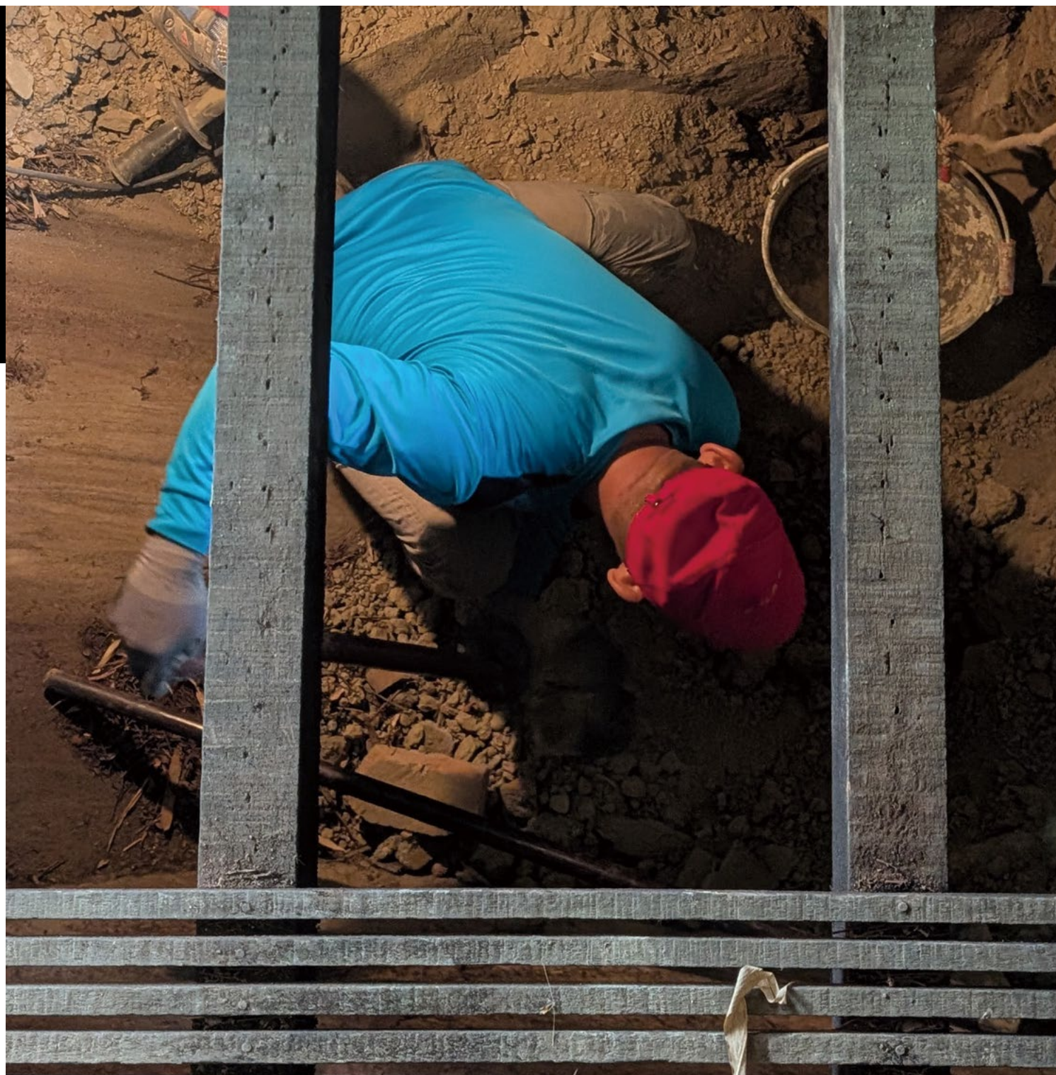
▲ 今年 0125 地震震央位於臺南東山區，導致東山多數龍眼焙灶毀損，圖中工人正在修繕焙灶 / 陳文彥
