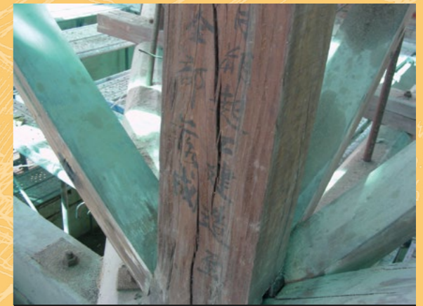
▲ 頤樓的西式屋架正同柱發現興建當時留下的字跡
