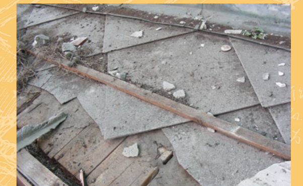
▲ 屋面隱蔽部位原有石棉材質之菱形板瓦
