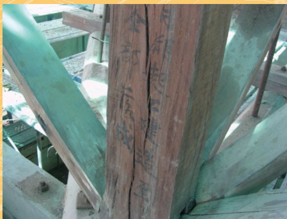
▲ 頤樓的西式屋架正同柱發現興建當時留下的字跡
