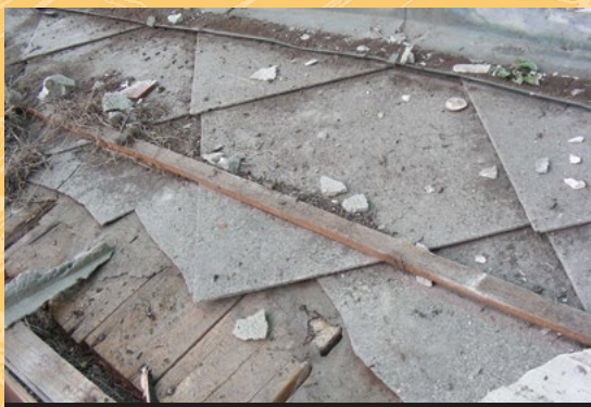
▲ 屋面隱蔽部位原有石棉材質之菱形板瓦
